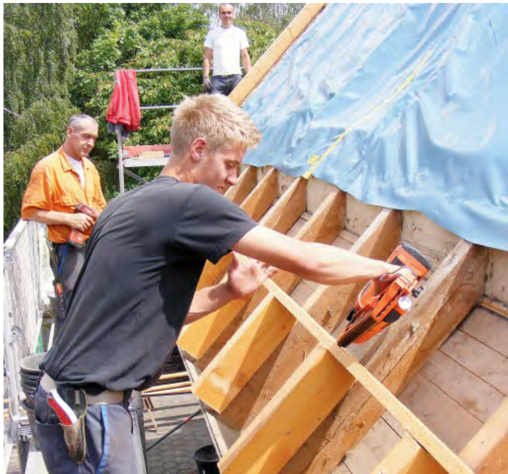
Energieeinsparverordnung im Alltag: Dieter Renner, Thorben Lhotzky und Mike Baltimore (von links) von der Firma Drewes-Dächer bereiten die Unterkonstruktion fürs Dämmen vor. FOTO: PRIVAT
